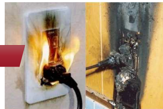
コンセント事故事例
